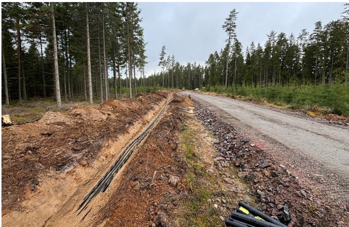
Figur 12 Pågående kabelförläggning. I kabelschakten finns två kablar, optorör och jordlina. Foto: Barman Consulting AB
