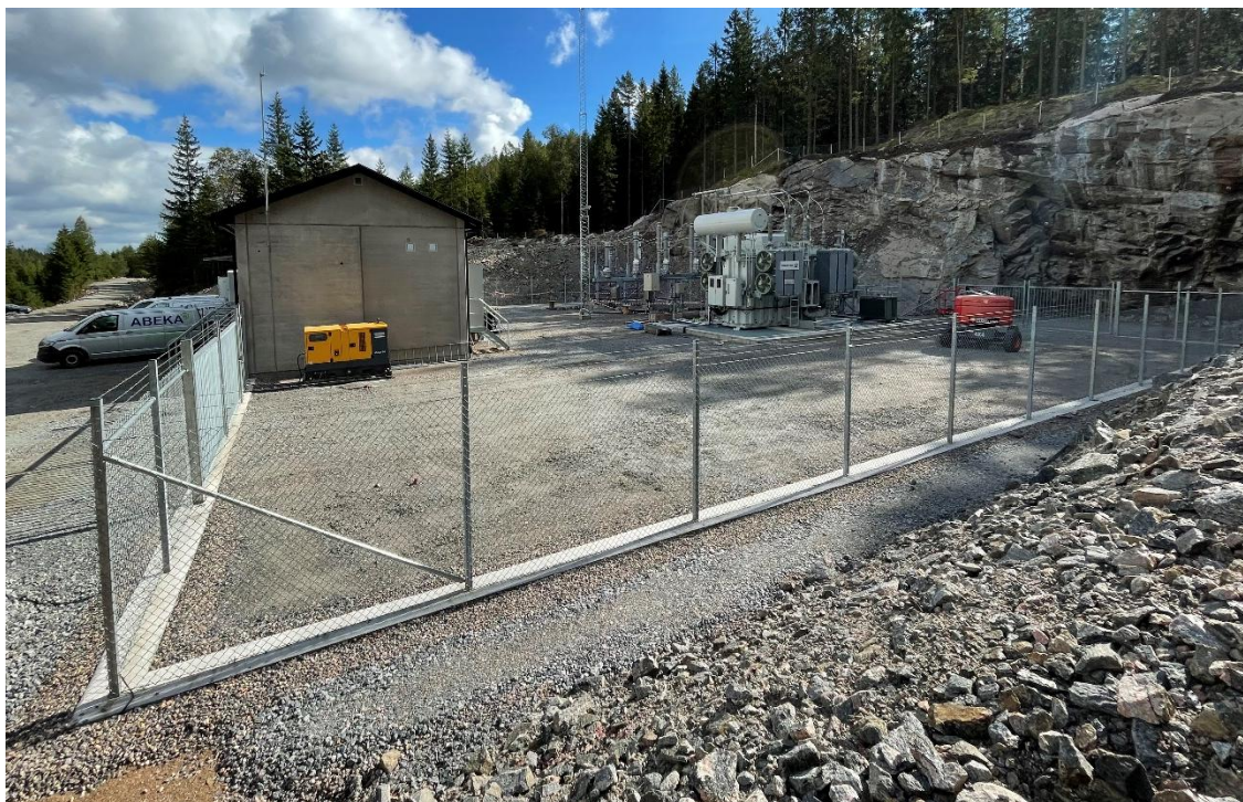
Figur 13 Utomhusställverk i vindpark. Foto Jonas Barman
